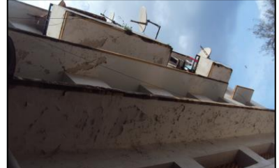
Photo6: Dégradation des portes à faux et des balcons. Source : Photo prise par auteur le 29 Avril 2013 à 10h.30.
