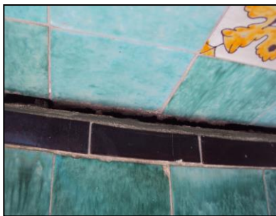
Photo2: Dislocation des murs suite à une perte de cohésion. Source : Photo prise par auteur le 29 Avril 2013 à 10h.30.
