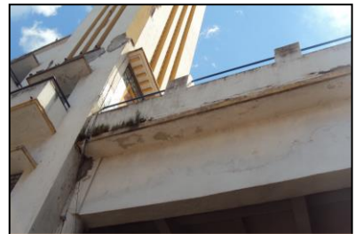
Photo3: Décollement des enduits et présence des herbes. Source : Photo prise par auteur le 29 Avril 2013 à 10h.30.
