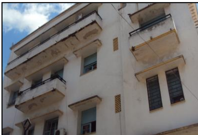
Photo1: Faïençage et décollement de la peinture. Source : Photo prise par auteur le 29 Avril 2013 à 10h.30.
