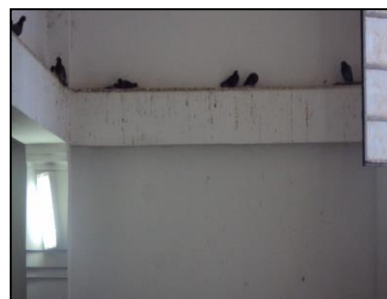
Photo9: Présence des salissures des pigeons. Source : Photo prise par auteur le 29 Avril 2013 à 10h.30.
