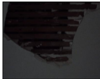
Photo3: Effondrement d'une partie du faux plafond. Source : Photo prise par auteur le 29 Avril 2013 à 10h.30.
