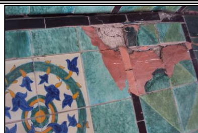
Photo3: Dégradation de la faïence. Source : Photo prise par auteur le 29 Avril 2013 à 10h.30.
