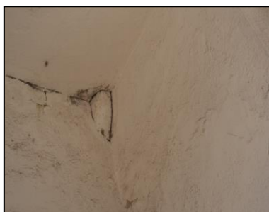
Photo7 : Traces des infiltrations des eaux au niveau du plafond. Source : Photo prise par auteur le 29 Avril 2013 à 10h.30.
