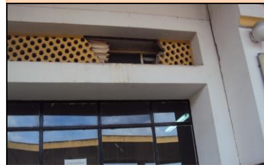
Photo8: Dégradation des claustras. Source : Photo prise par auteur le 29 Avril 2013 à 10h.30.
