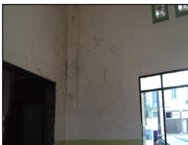
Photo8: Enduit et peinture défectueux par l'effet de l'humidité et infiltration des eaux. Source : Photo prise par auteur le 29 Avril 2013 à 10h.30.
