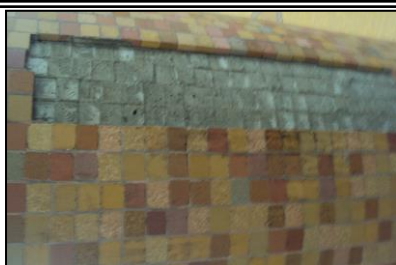
Photo1: décollement des grandes parties de la mosaïque des colonnes. Source : Photo prise par auteur le 29 Avril 2013 à 10h.30.
