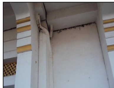
Photo6 : Défaillance des chéneaux. Source : Photo prise par auteur le 29 Avril 2013 à 10h.30.
