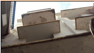
Photo7: Eclatement du béton et corrosion des armatures des balcons. Source : Photo prise par auteur le 29 Avril 2013 à 10h.30.
