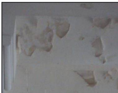
Photo4: Décollement de la peinture. Source : Photo prise par auteur le 29 Avril 2013 à 10h.30.
