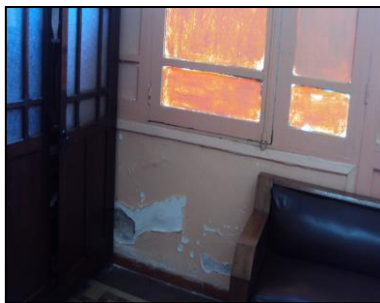
Photo1: vieillissement et décollement du mortier. Source : Photo prise par auteur le 29 Avril 2013 à 10h.30.
