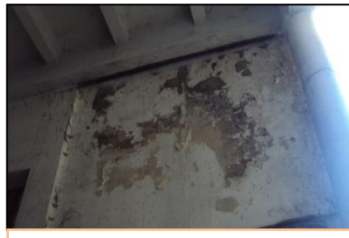
Photo2: Ecaillage de la peinture et présence de taches humide et moisissure. Source : Photo prise par auteur le 29 Avril 2013 à 10h.30.
