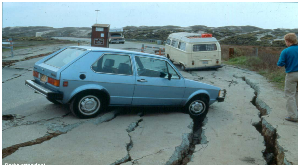
Figure 4.1- la route d'accès de la plage de Moss Landing (Idriss et Boulanger, 2008).
