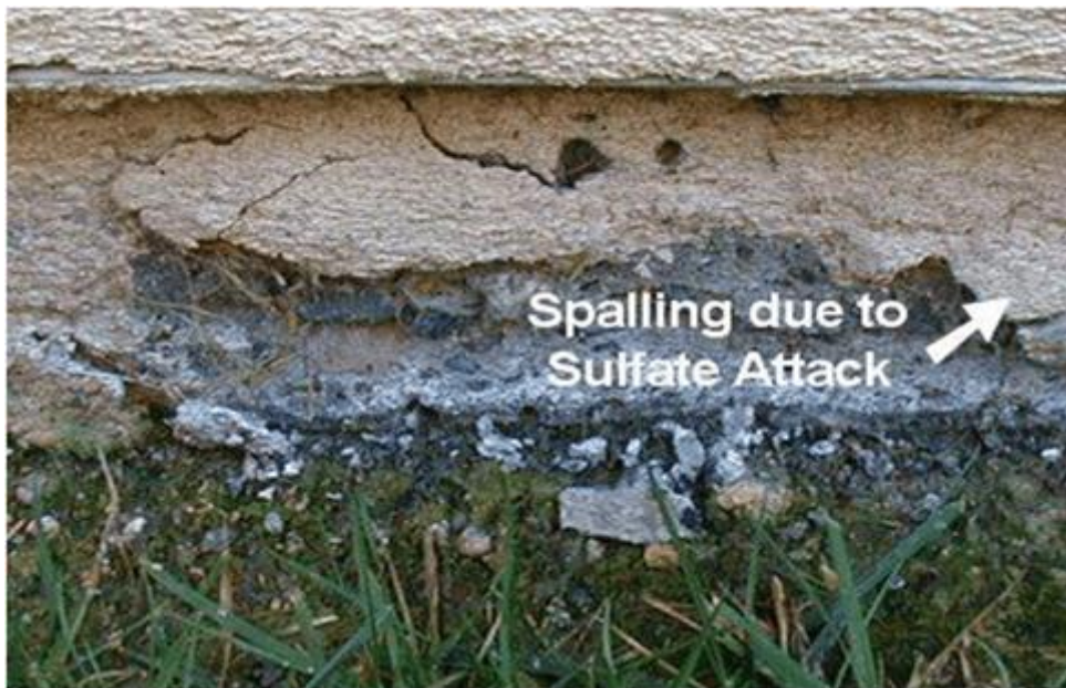
Photo 2. 3 : Dégradations causées par les attaques sulfatiques
