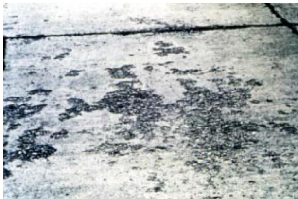
Photo 2. 1 : Détérioration de la surface du béton par Les cycles de gel dégel
