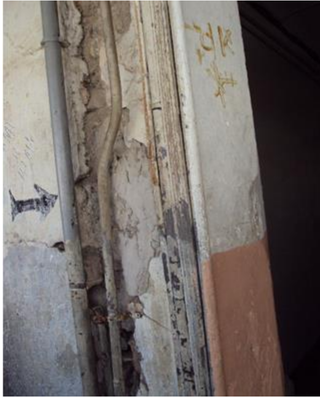
Photo 4. 2 : Dégradation des enduits
