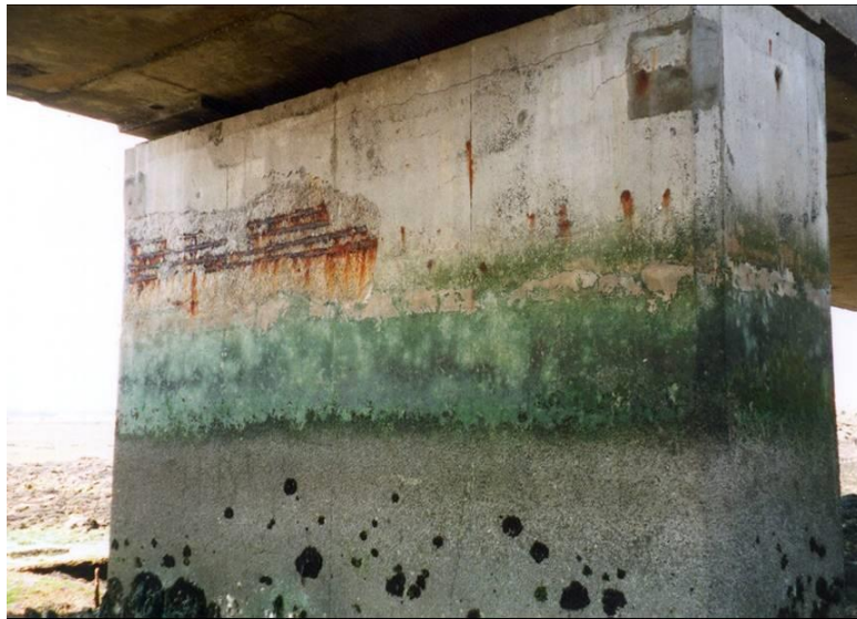
Photo 2. 2 : Dégradations causées par les attaques chimiques
