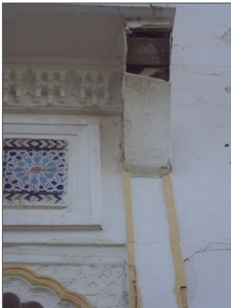
Photo I-13 : Console dégradée source : auteur (année 2013)
