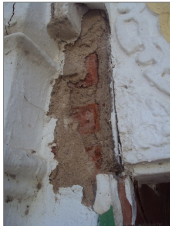
a- Mortier altéré
