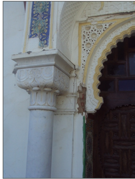
Photo 16-I : Fissuration et décollement d'enduit source : auteur (année 2013)
