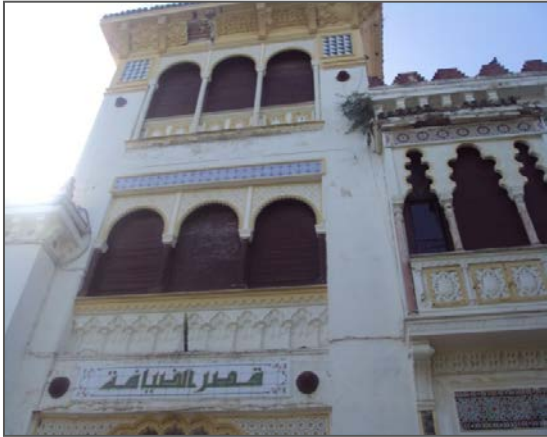
Photo I-11 : Apparition de la végétation sur la façade source : auteur (année 2013)
