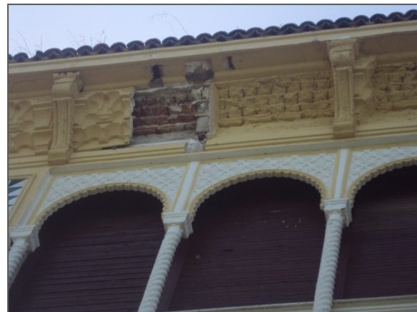
Photo I-14 : Corniche dégradée : apparition de la brique. source : auteur (année 2013)
