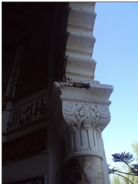
Photo I-17 : Dégradation des éléments décoratifs source : auteur (année 2013)
